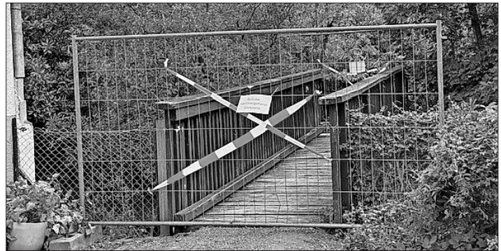
Brückenspernung beim Teppichhaus Kern.
