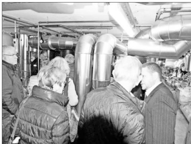
Es gab auch Gelegenheit, die Heizzentrale zu besichtigen.
