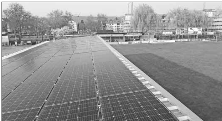
Photovoltaikanlage der BEG Teningen auf dem Tribürendach beim Friedrich-Meyer-Stadion.
